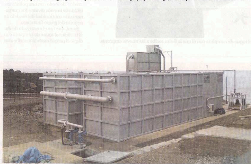
Planta potabilizadora de agua instalada por la empresa Trabinox en Malabo (Guinea Ecuatorial). CEDIDA
